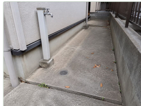
立水栓まわり
