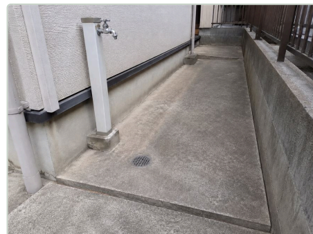
立水栓まわり
